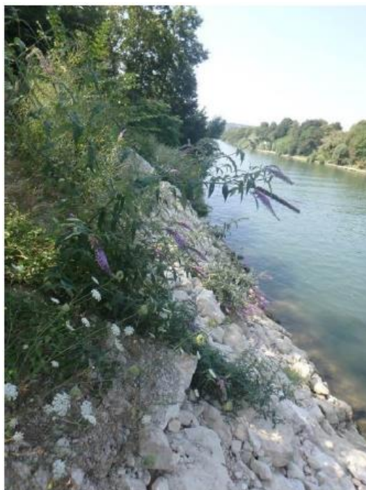
Travaux de confortement - colonisation par le Buddléja du père David
